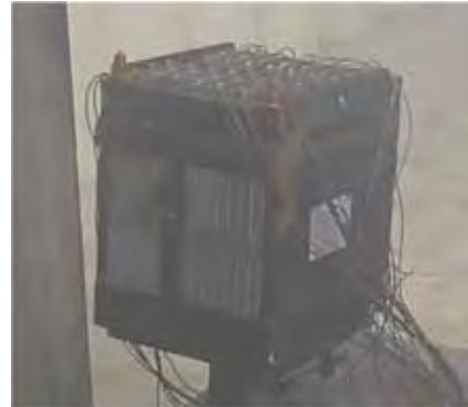
類焼せず、モジュールとしては鎮静化
