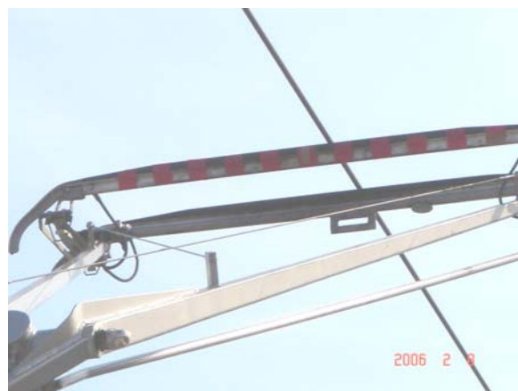
写真12 タイヤパンク時のパンタグラフと集電線の位置関係例
