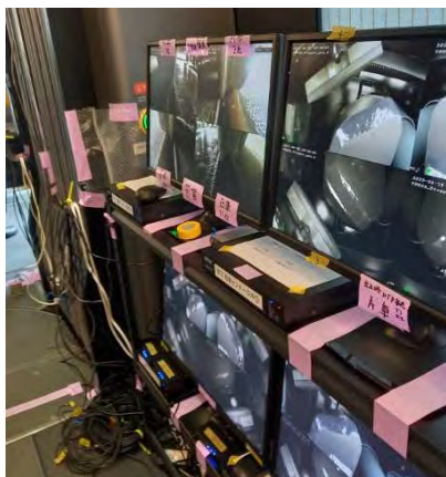
試運転中の車内
