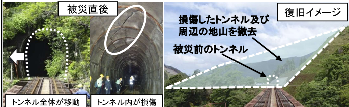
南阿蘇鉄道(平成28年4月熊本地震により被災)
