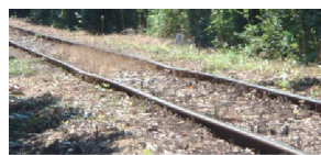
軌道変位大、道床不良の例
