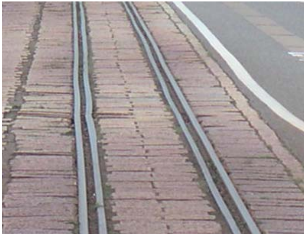
枕木の腐食や通過自動車による軌道不整
