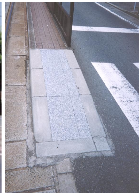
車椅子のすれ違い や方向転換も困難
