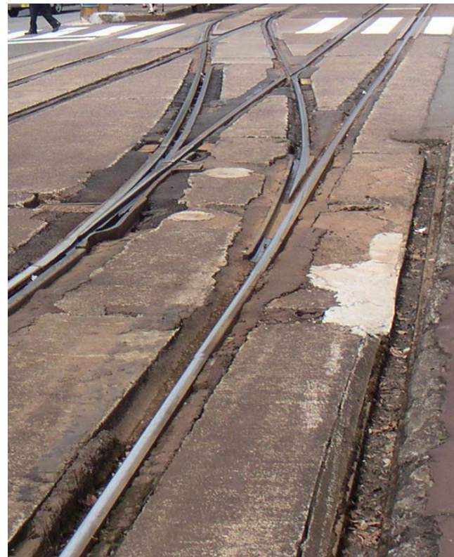
老朽化した設備
