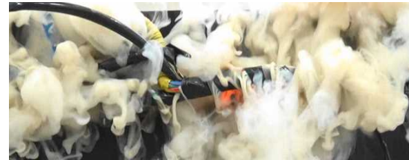
(バッテリーショート通電後煙発生)
