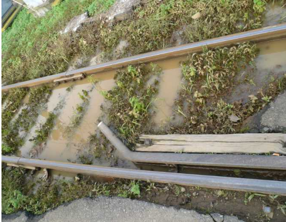
雨水による浸水
