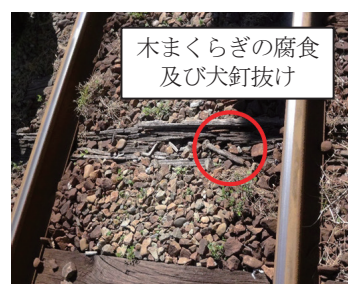
図1 木まくらぎ及び締結装置（犬釘）の不良
