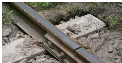
図2 浮き枕木発生区間
