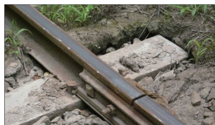
図2 浮きまくらぎ
