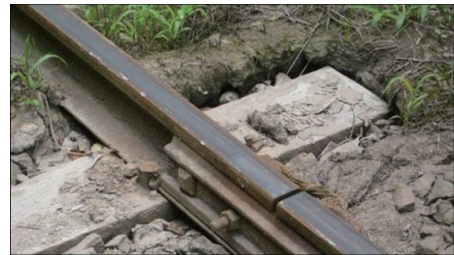
図2 浮きまくらぎ
