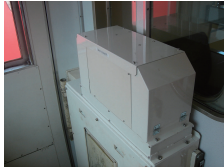
図3 運転状況記録装置の搭載例（専用ケース内）
