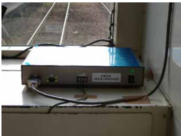
図6 速度データ取得装置設置状況
