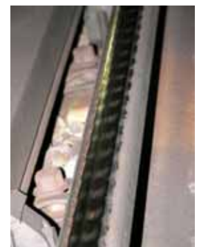
図3 試験区間のレール波状摩耗の状況
