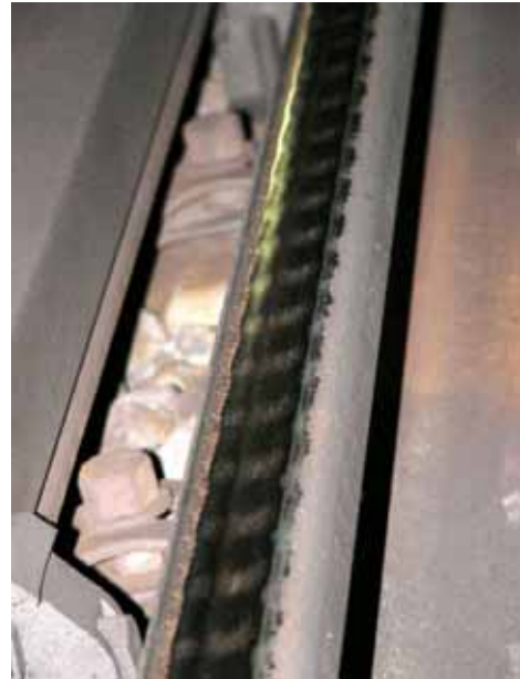
図10 現場付近に発生していた レール波状摩耗の状況
