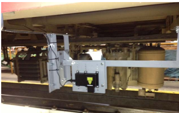
位置把握精度検証のため列車床下に設置したセンサ
