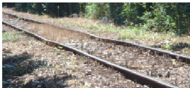
軌道変位大、道床不良の例
