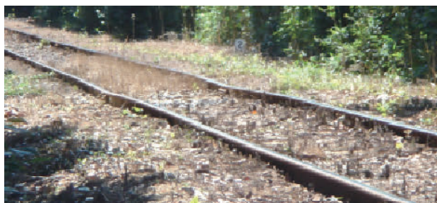
軌道変位大、道床不良の例
