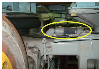
ダンパの故障模擬検証実験
