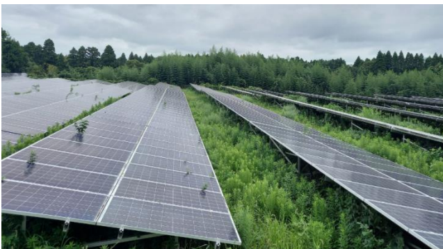
図7 中山間地の太陽光発電所
